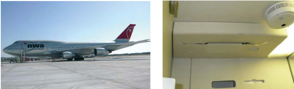
Fig. 4.6-1 事故機（左図）と化粧室天井部の亀裂破損状況（右図）。出典：運輸安全委員会事故調査報告書 4.8.2)
